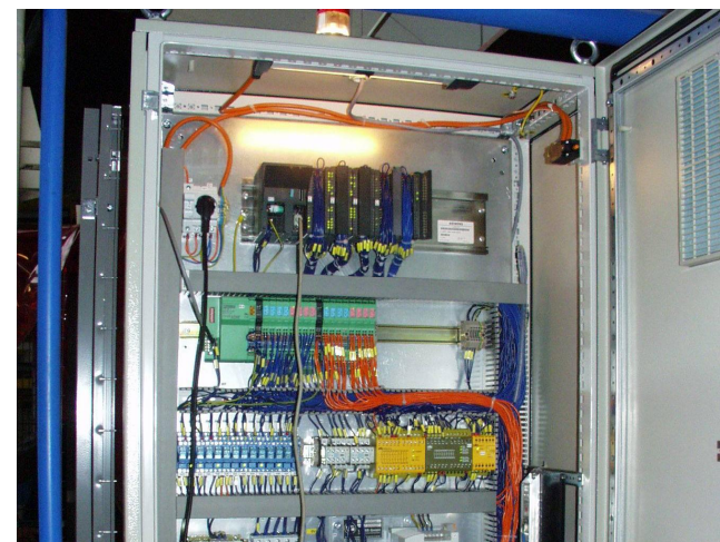
SIMATIC S7-314, In Line moduly PHOENIX, bezpečnostní relé PILZ
