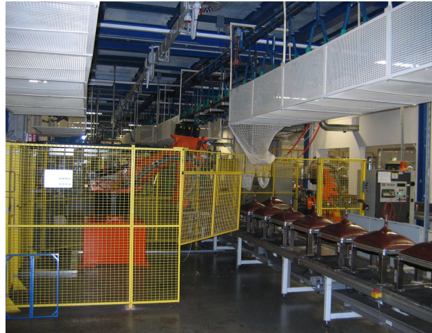
Allgemeiner Blick auf Förderstrecken
