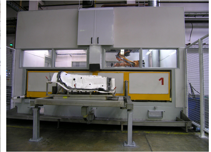
ABB Kabine nach der Rekonstruktion mit KUKA Robot
