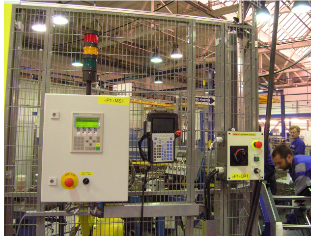
Systemsteuerung der Linien und Roboter
