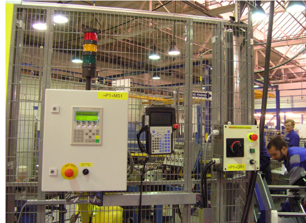
Панель управления линии и робота
