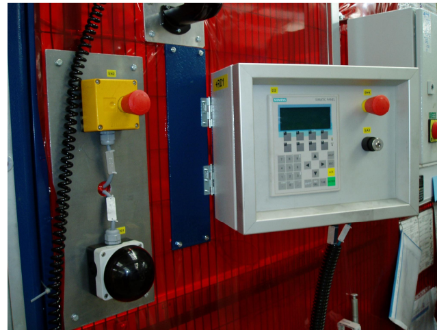
Шкаф управления и панель OP 77
